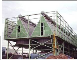
AIR COOLER 氣冷設備
